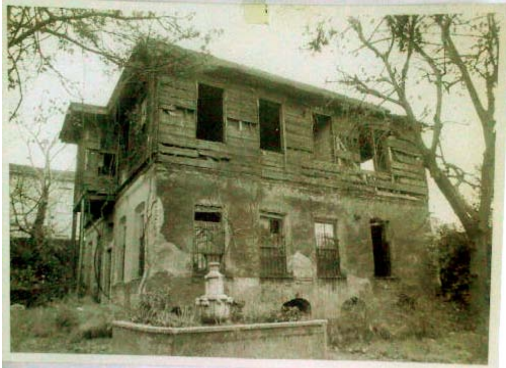
Resim 48: Yapı zemin katı taş – tuğla karışık örgü tekniği ile inşa edilmiştir (İsmail Hakkı Konyalı Kitaplığı - İsmail Hakkı Konyalı Arşivi – Selimiye).
