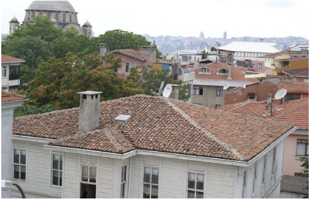
Resim 49: Bina çatısı dört yöne eğimli kırma çatıdır ve alaturka kiremit ile kaplıdır.
