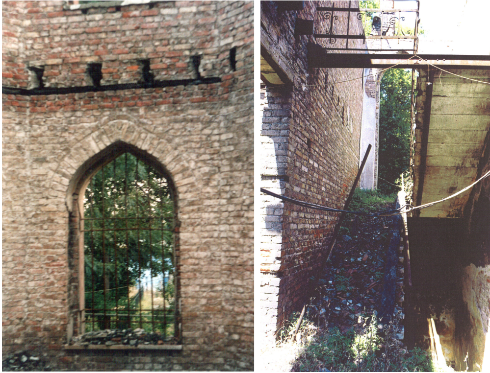
Şekil 3.22 1997 yangınından sonra şeyh dairesi iç mekan görünüşü
