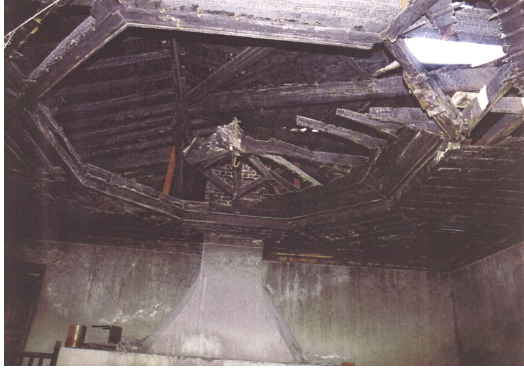
Şekil3.66 Matbahın 1997 yangınından sonraki durumu
