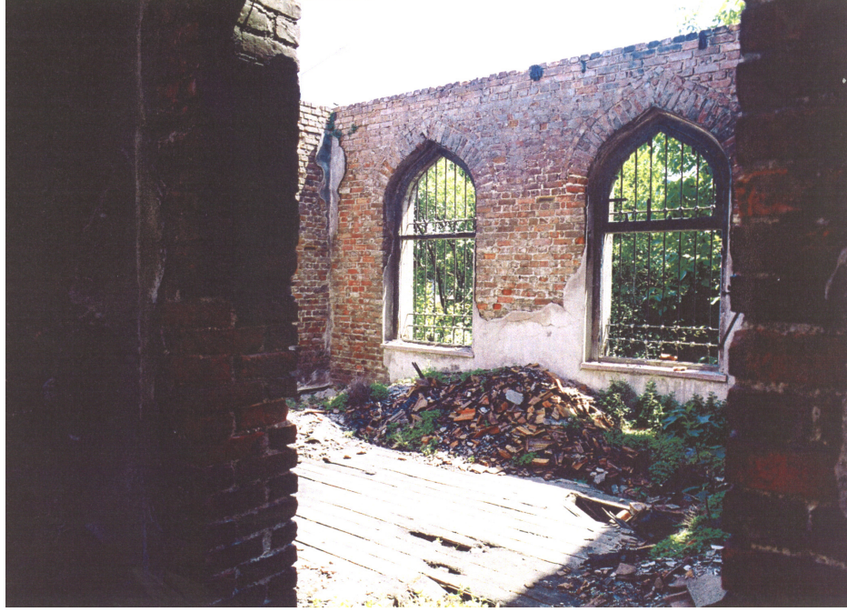
Şekil 3.23 1997 yangınından sonra şeyh dairesinin iç mekan görünüşü
