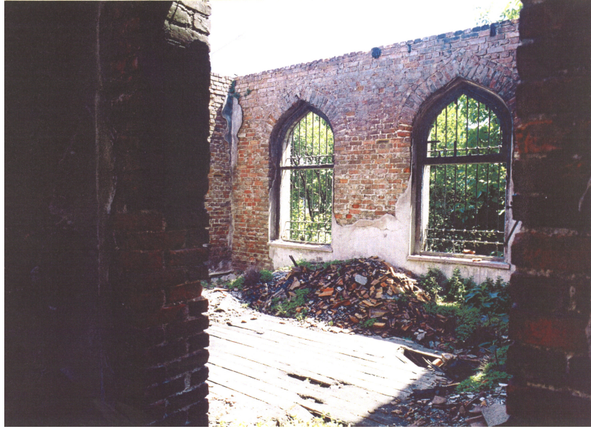
Şekil 3.67 Meydan-1 şerifin 1997 yangınından sonraki durumu
