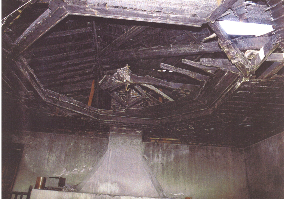
Şekil 3.25 1997 yangınında matbahın yanmış kubbesinin görünüşü
